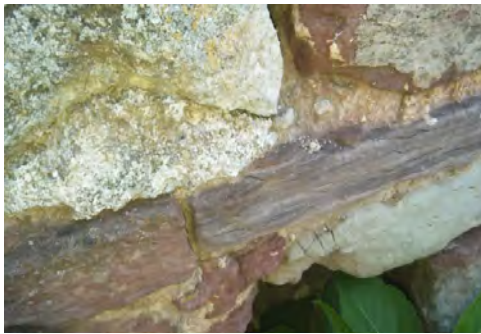
Рис. 9. Руйнування шовного матеріалу, тріщинуватість.
